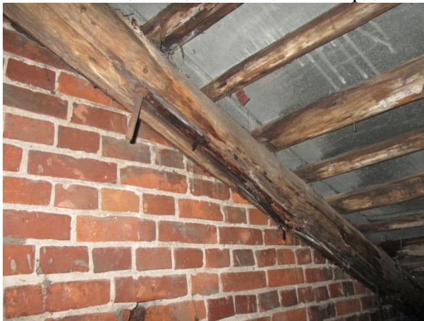
Ф.3.5 Гниение и разрушение участков стропильных ног в осях 2/В-Д
