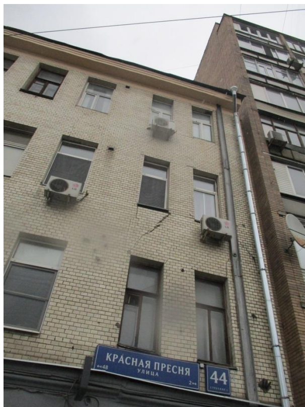
Ф.1.12 Наклонные трещины в кирпичной кладке стены в осях 2-1/Д. Ширина раскрытия до 10 мм. Стальной элемент усиления.
