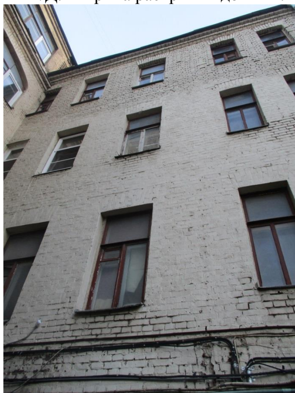
Ф.1.19 Выветривание швов, выпадение отдельных кирпичей кладки стены в осях 8-10/А
