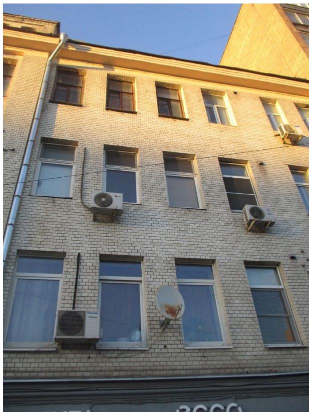
Ф.1.17 Наклонные трещины в керамической фасадной плитке в осях 4-1/Д. Ширина раскрытия до 2 мм.
