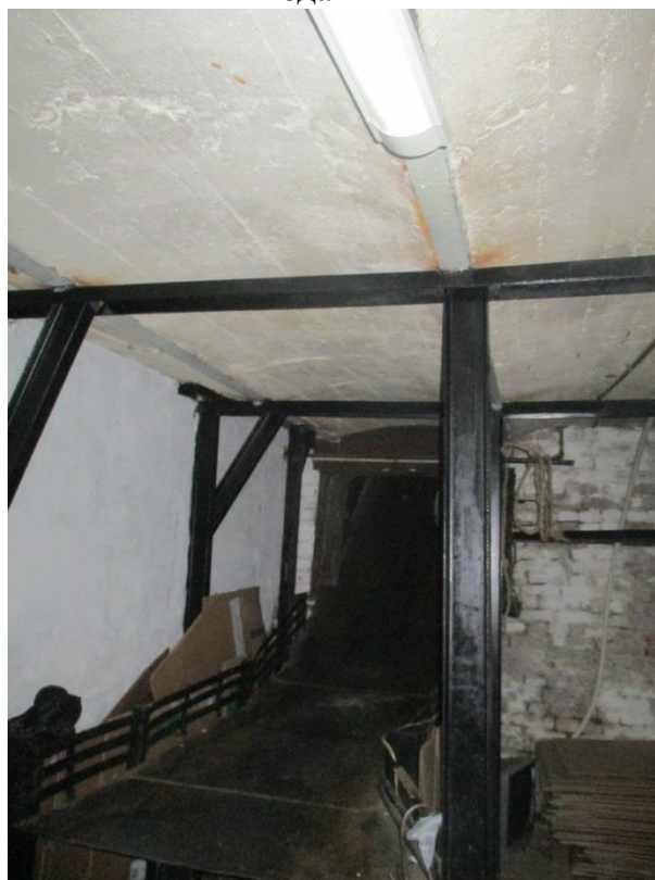
Ф.2.4 Общий вид подпорный рамы в осях 6-9/Г-Д
