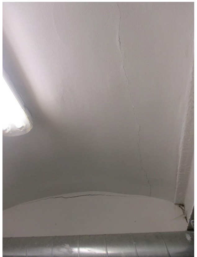
Ф.2.12 Волосяные трещины в штукатурном слое сводов в осях 4-6/В-Д. Ширина раскрытия до 3 мм
