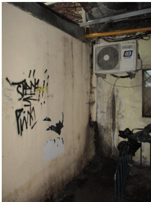
Ф.1.8 Следы увлажнений, протечек и высолы на отделке стены
