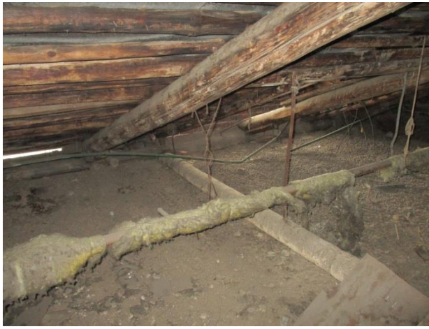
Ф.3.7 Расслаивание деревянных элементов вследствие усушки. Поражение жучком и биологические повреждения обрешетки и несущих конструкций крыши
