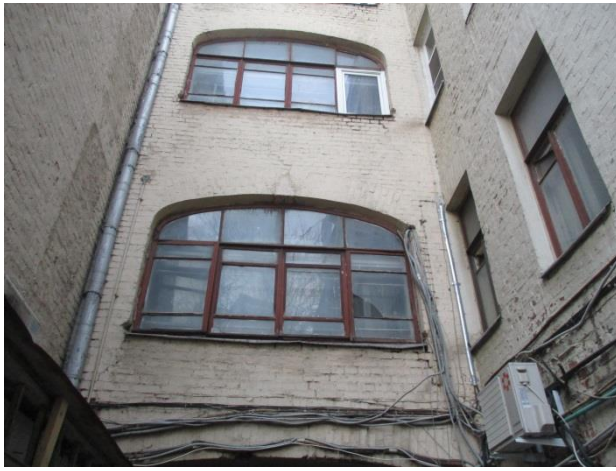
Ф.1.21 Наклонные трещины в кирпичной кладке стены перехода в осях 8с/Ас-А. Ширина раскрытия до 3 мм.
