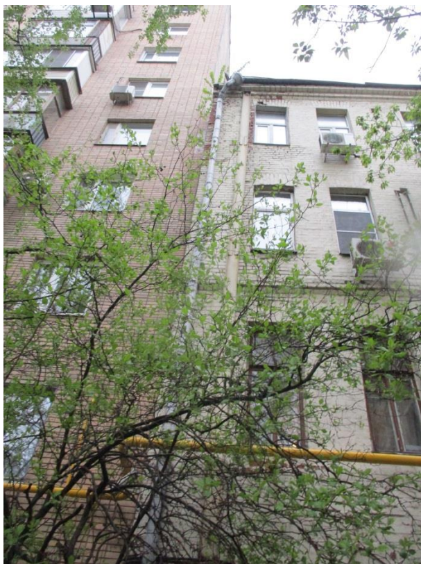
Ф.1.9 Деградация кладки на локальном участке в осях 1-2/А. Стальной элемент усиления.
