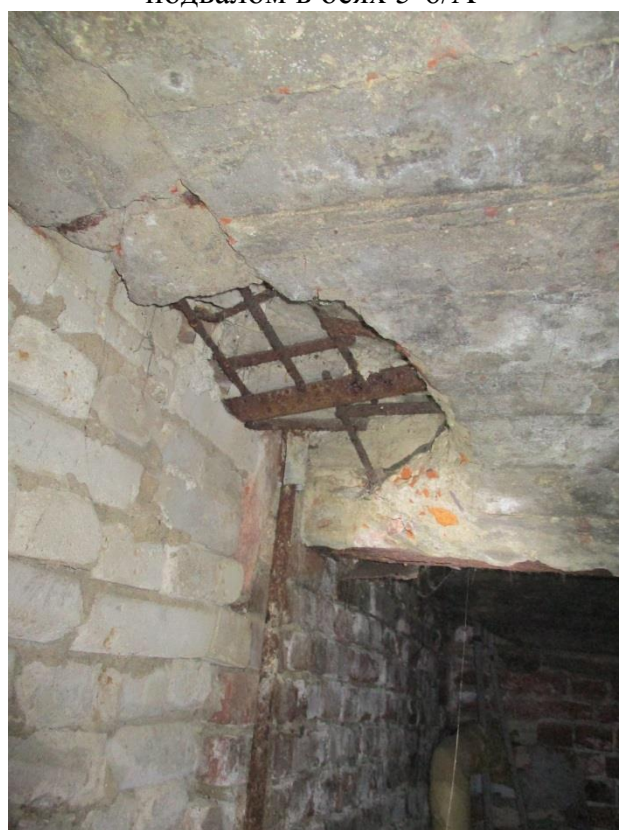
Ф.2.7 Сколы бетона сводов перекрытия с обнажением и сплошной слоистой коррозией арматуры на локальных участках в осях 5-6/А
