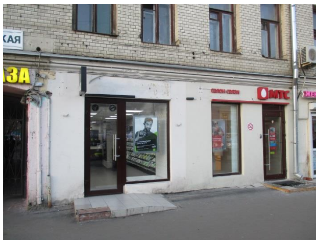
Ф.1.15 Отверстия и сколы в кирпичной кладке простенков в осях 9-6/Д
