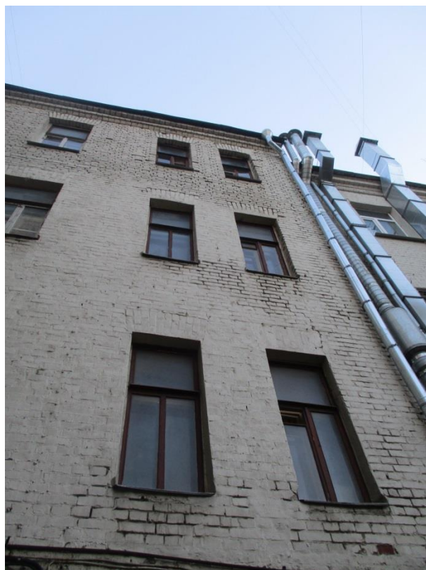
Ф.1.18 Наклонные трещины в кирпичной кладке стены в осях 9-10/А. Ширина раскрытия до 3 мм.
