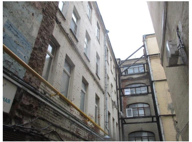
Ф.1.22 Сколы в кирпичной кладке простенков. Наклонные трещины в кирпичной кладке стены перехода в осях 7с/А-Ас. Ширина раскрытия до 3 мм.
