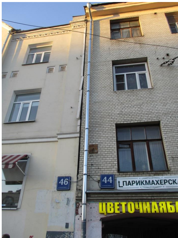
Ф.1.13 Наклонные трещины в керамической фасадной плитке в осях 10-9/Д. Ширина раскрытия до 2 мм.
