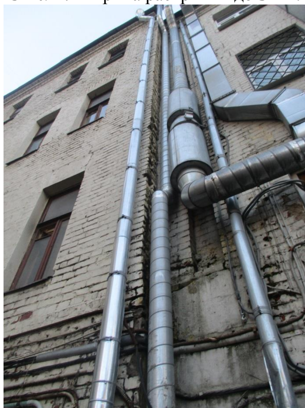
Ф.1.20 Следы увлажнений кирпичной кладки на локальном участке в осях 10/А.
