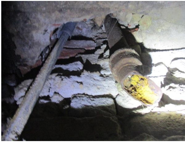
Ф.2.9 Устройство отверстия в кирпичном своде перекрытия в осях 5-6/А без выполнения компенсационных мероприятий. Повреждение рабочей арматуры и защитного слоя бетона
