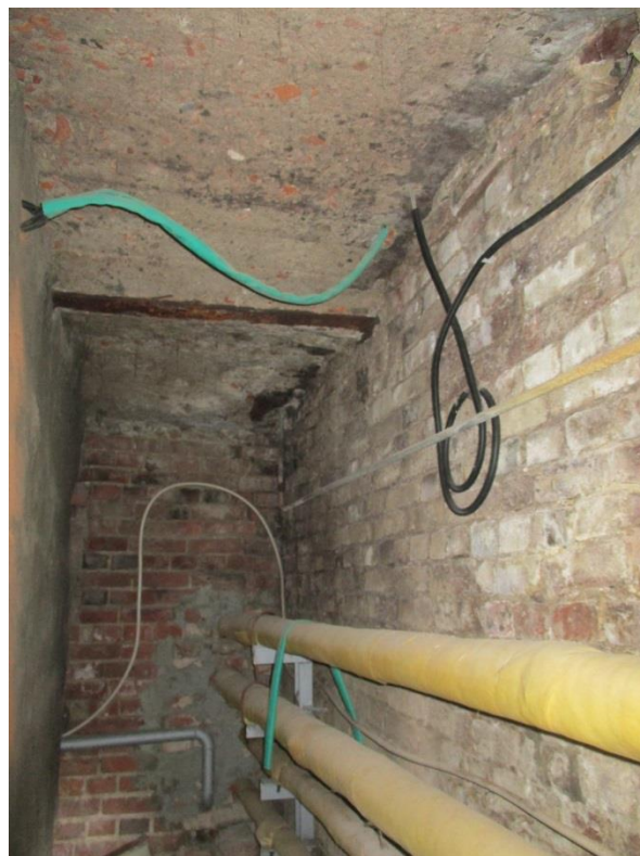
Ф.2.5 Сплошная пластинчатая коррозия стальных балок перекрытия над подвалом в осях 5-6/А
