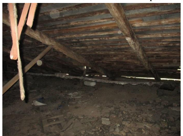
Ф.3.6 Отсутствие отдельных опорных подкосов стропильных ног в осях 1-3/А-Д
