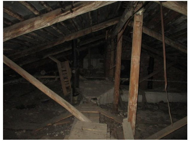
Ф.3.8 Расслаивание деревянных элементов вследствие усушки. Поражение жучком и биологические повреждения обрешетки и несущих конструкций крыши
